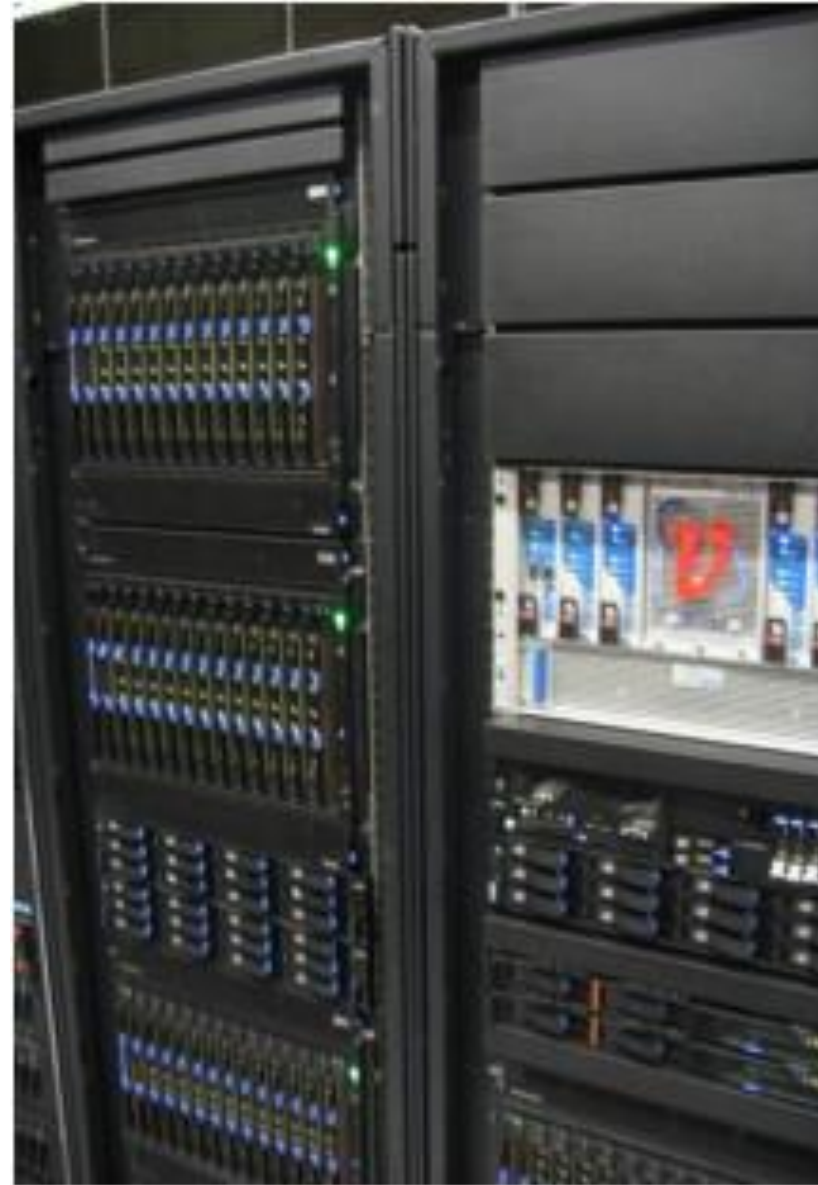
MariCel está en 2 racks de la sala de MareNostrum
