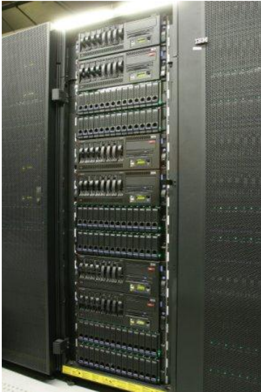
Racks de los servidores de almacenamiento
